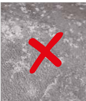
einfache Ausführung: Korrosion
